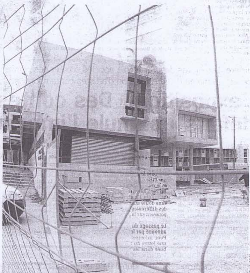
Depuis juillet dernier le Centre social à Berthe est en grand chantier. Les travaux, qui s'inscrivent dans le cadre du projet de rénovation urbaine du quartier, seront achevés en juin.
